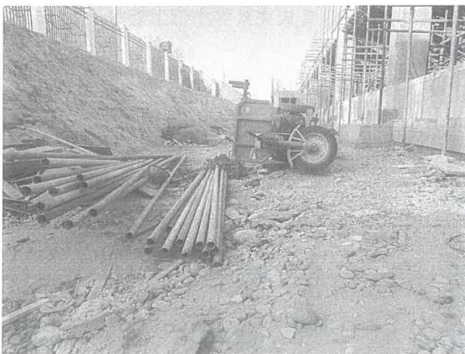
图 4 事故现场北侧照片
